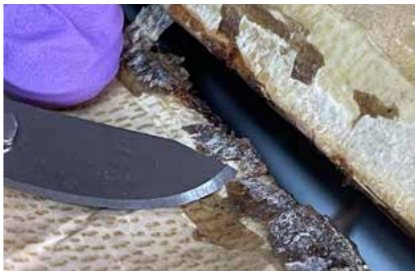
Excesos de adhesivo de la intervención anterior
