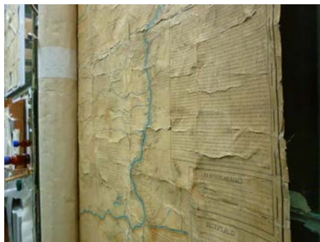
FOTO 3. FISURAS Y RASGADURAS SOBRE TODA LA SUPERFICIE DE LA OBRA.
